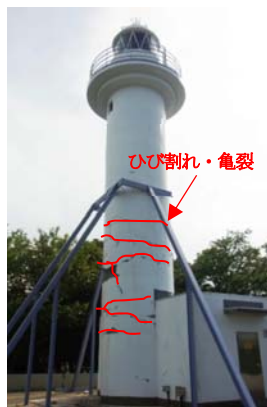
図 2 大津岬灯台(RC 造)の地震被害状況
