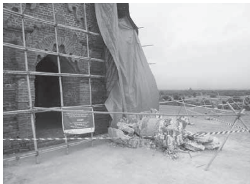
【写真12】ディヤダッタジ寺院の地震による被害
