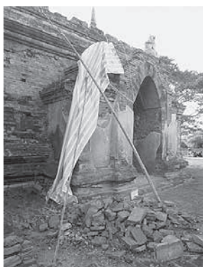
写真11 アバヤダナ・パヤーの地震による被害
