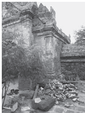
【写真13】ダマヤツズカ・パヤーの地震による被害
