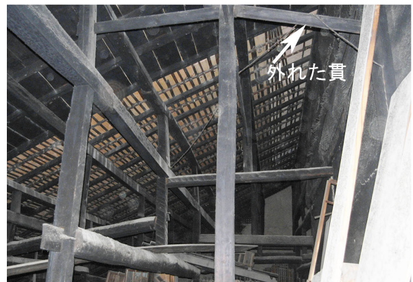
図8 I家の背面小屋組。貫が外れている
