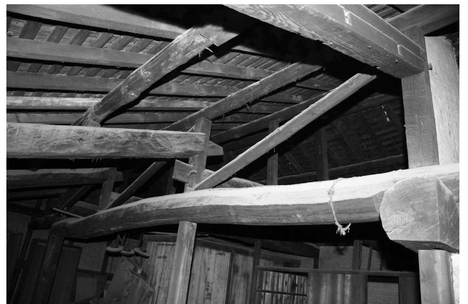
図 18 K 家住宅 母屋桁筋で入れた筋交い
