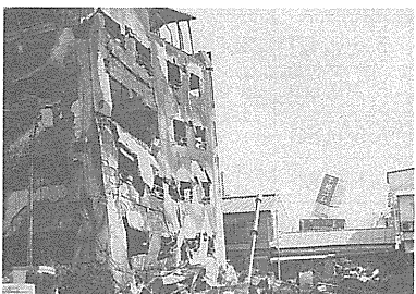
写真3 構造体が破損し延焼を受けた耐火構造物（筆者撮影）
