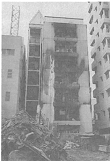
写真4 耐火建築物の被害 ：鉄骨造 ALC 外壁・各階5住戸のマンションが2階から7階まで約20時間かけて延焼した例（筆者撮影）
